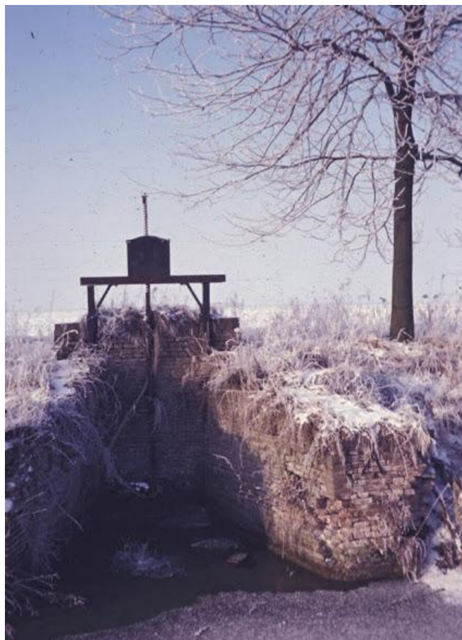
Afb. 12 Duikersluisje Poldersekade vóór de restauratie
